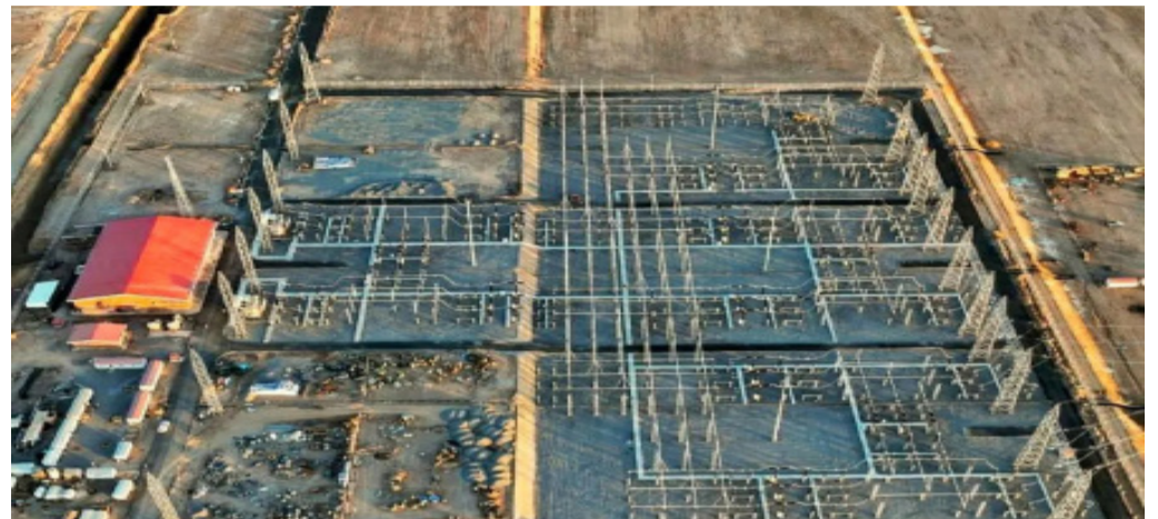
معاون مدیرعامل و مدیر مجتمع سایت بردسیر شرکت گهرزمین اعلام کرد: پست اختصاصی برق ۴۰۰/۳۳ کیلوولت با هدف تأمین پایدار انرژی طرح‌های
